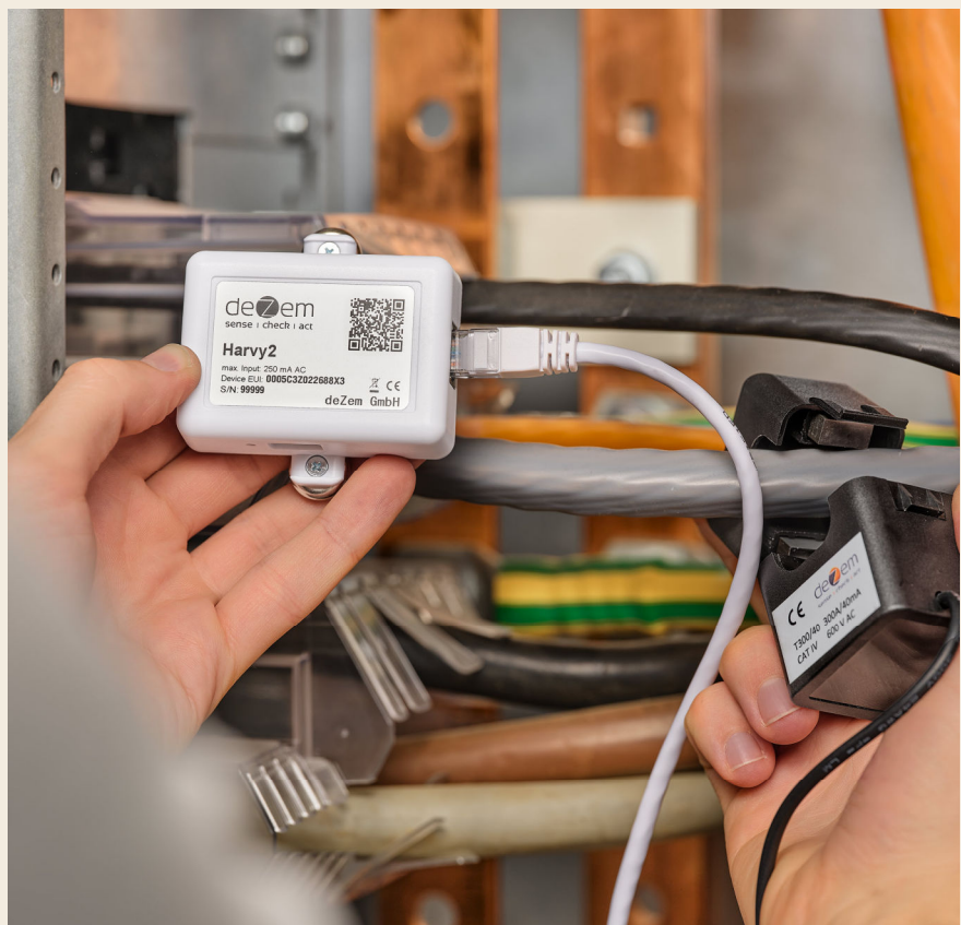
Mit den passenden Klapstromwandlern ist der Harvy2 schnell installiert und verschickt die Messdaten laufend per LoRaWAN. Foto: deZem
